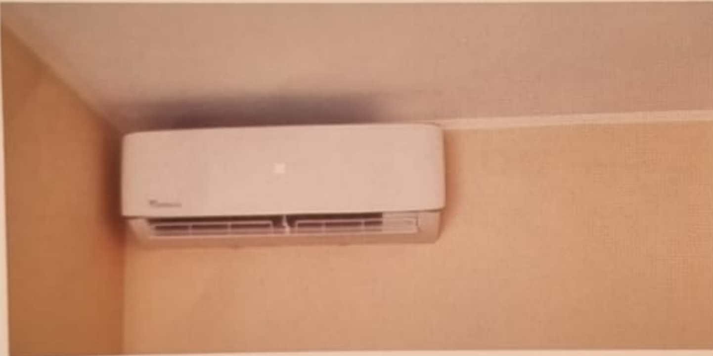
MUY PEGADO AL TECHO O AL MURO
